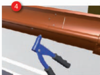
Заклепайте патентованными заклепками PREFA 4 x 10 мм, располагая их в крестообразном порядке (6 шт. заклепок для водосточного желоба \varnothing 100 мм, 8 шт. заклепок для водосточного желоба \varnothing 125 мм и \varnothing 150 мм, 10 шт. для водосточного желоба \varnothing 190 мм).
